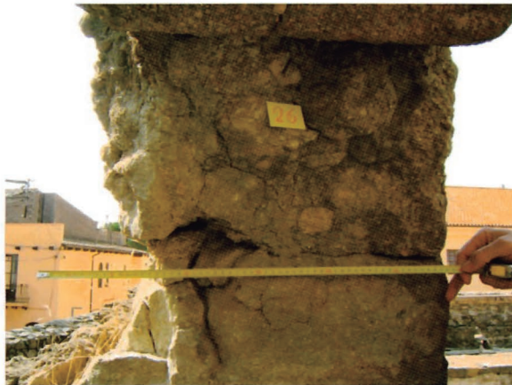
Figura 21.1. Primer pla d'una dovella de les termes romanes de Caldes de Malavella. Les dovelles de la cara sud han perdut prop de vint centímetres.
