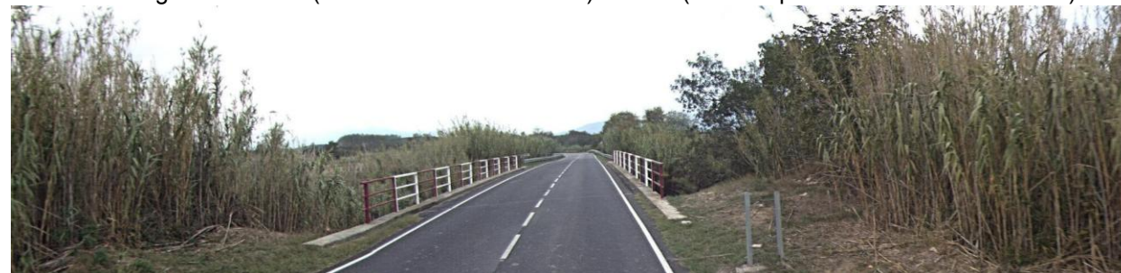
Carretera actual en el PK 1+350 al creuar la zona de protecció (riera Orlina)
