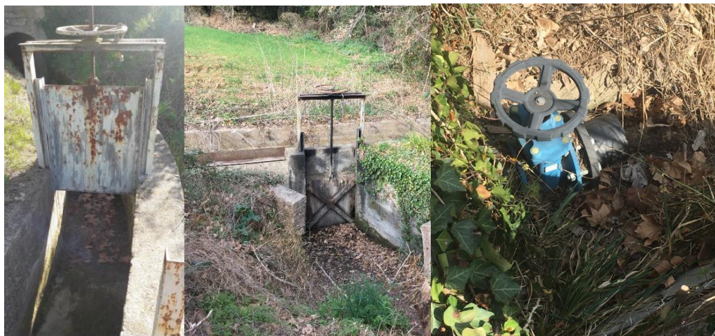
FIGURES 3, 4 i 5. D'esquerra a dreta, comporta de guies [ABC2], comporta de guies per a buidat i hidrant de parcel·la.
