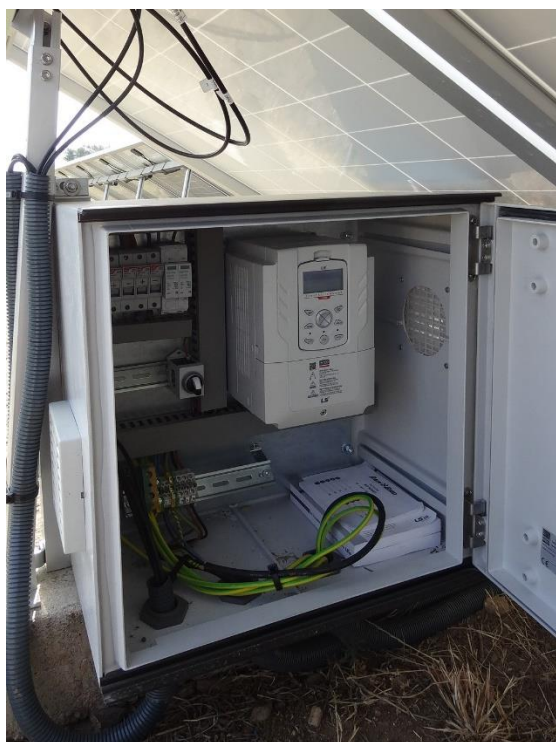
FIGURA 5. Detall del variador de freqüència d'una instal·lació de reg solar.
